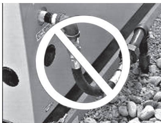
Figura 5.4 - Tendido incorrecto de la manguera flexible
