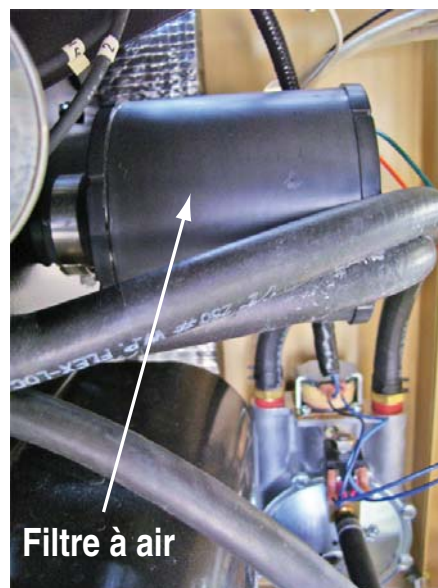
Figure 4.6 - Filtre à air du moteur de 10 kW
