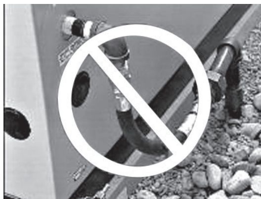
Figura 5.4 - Tendido incorrecto de la manguera flexible
