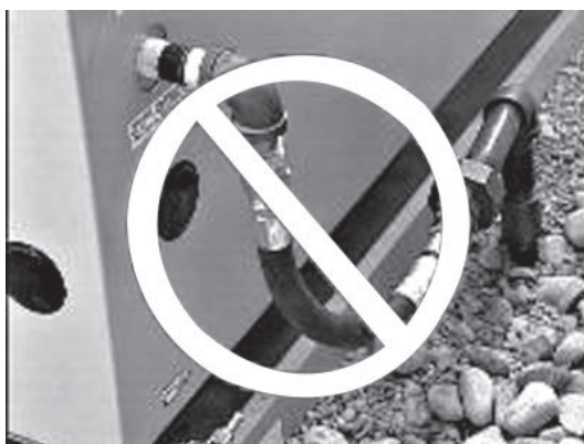
Figure 5.4 — Disposition inadéquate du tuyau flexible
