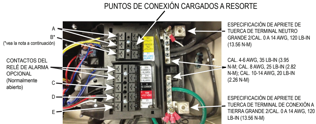
Figura 6.1 - Cableado de control (se encuentra detrás de la tarjeta de control)
