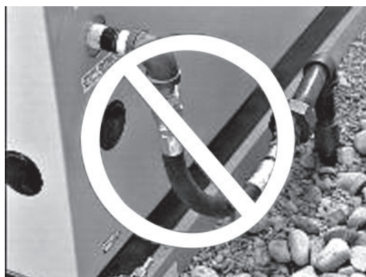
Figure 5.4 — Disposition inadéquate du tuyau flexible
