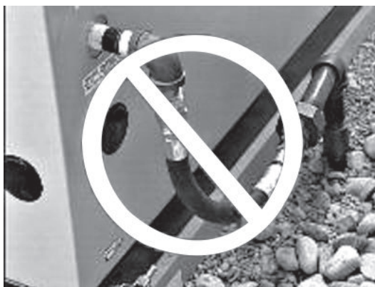
Figura 5.4 - Tendido incorrecto de la manguera flexible
