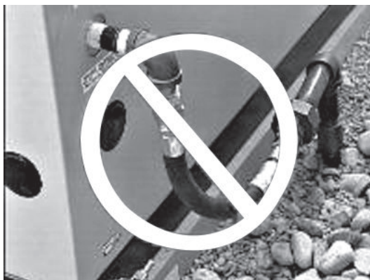
Figure 5.4 — Disposition inadéquate du tuyau flexible
