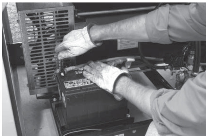
Рисунок 1.15. Проверка клеммных соединений
